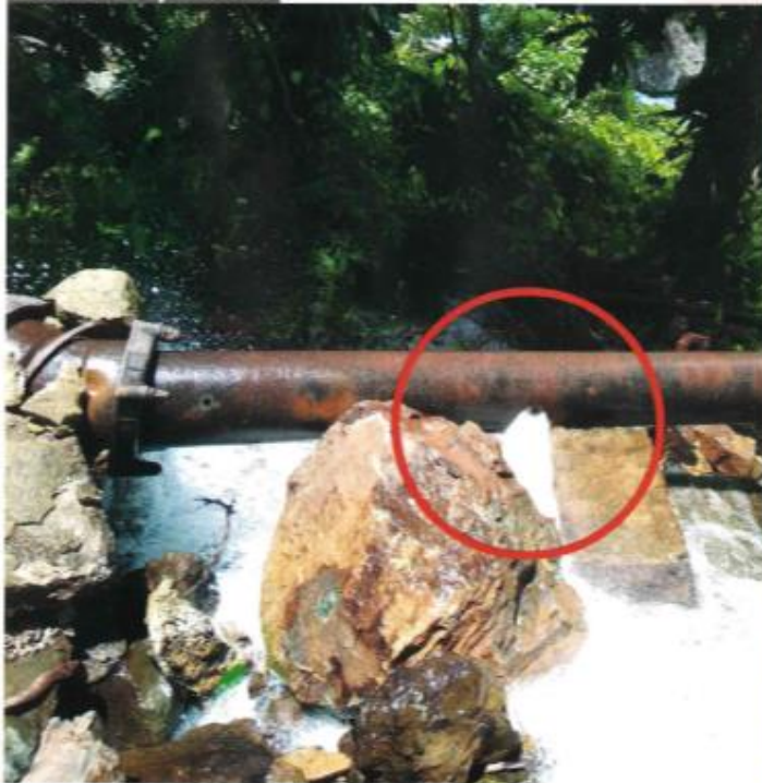
Avant la réparation
